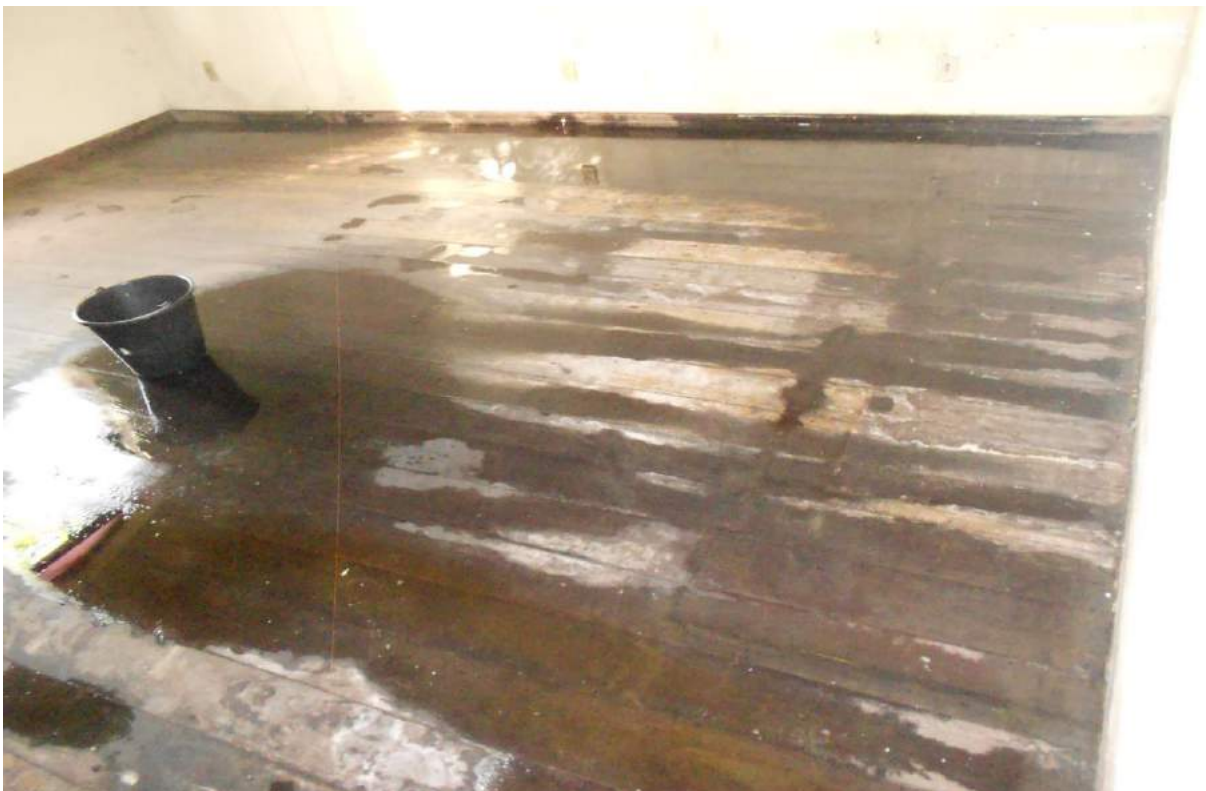
Foto 03 – Piso de taboa corrida danificada pela infiltração.
