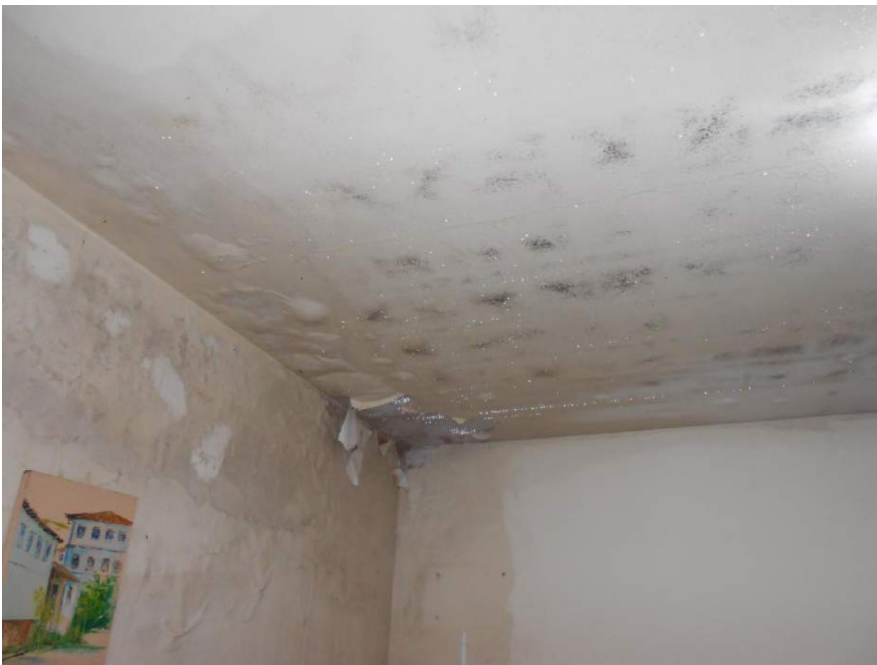
Foto 01 – Marcas de infiltração.
