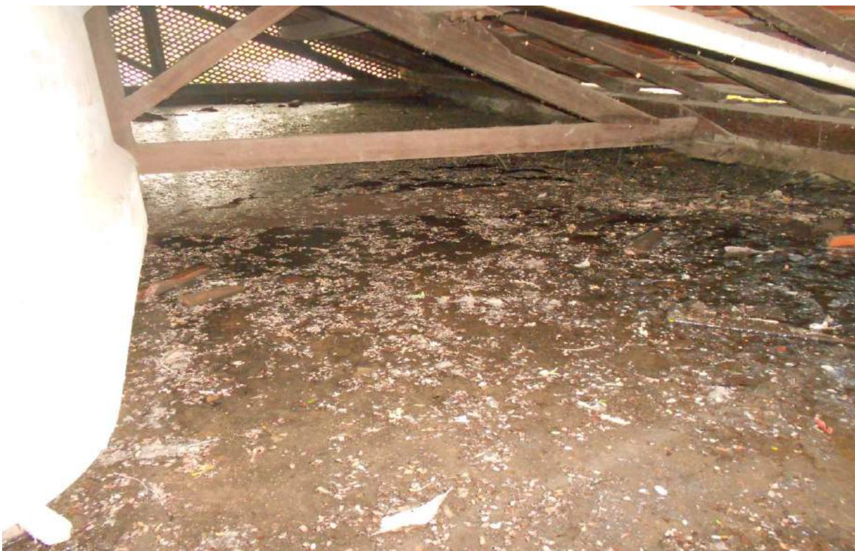
Foto 08 – Acumulo de água na laje.
