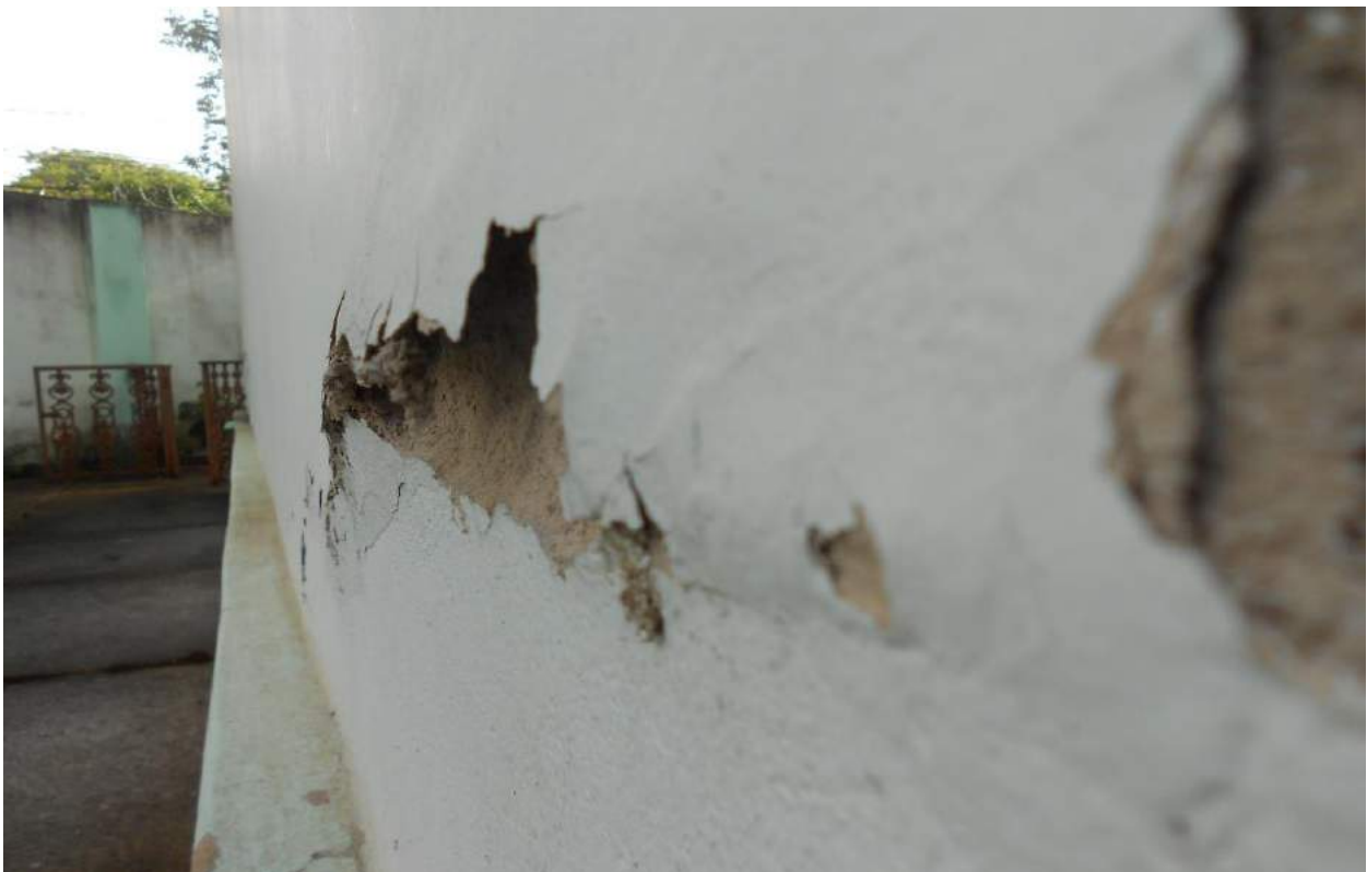
Foto 13 – Deterioração do reboco.
