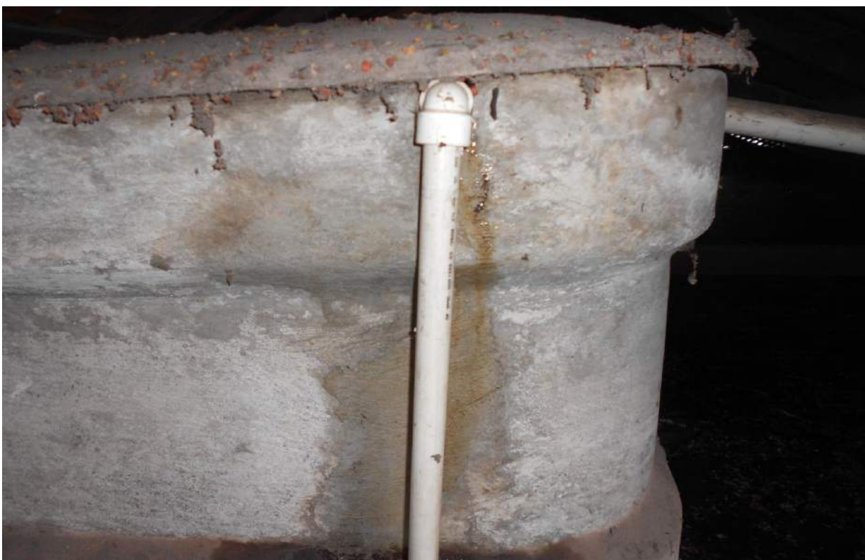
Foto 09 – Vazamento na caixa d'água.
