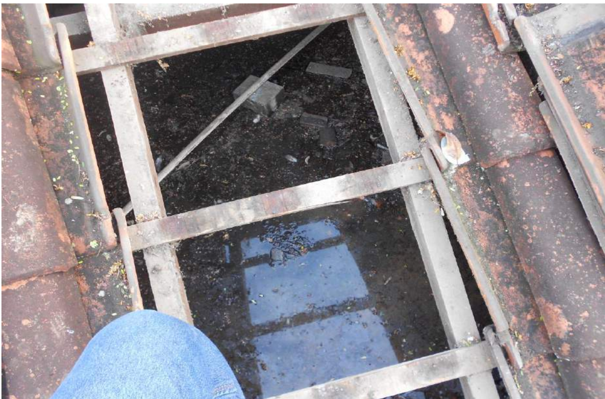
Foto 07 – Presença de água na laje.
