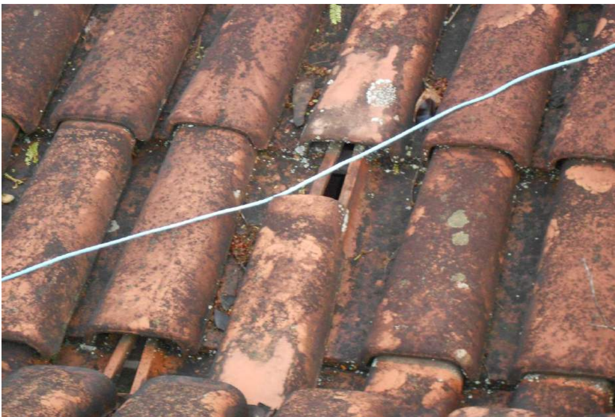
Foto 06 – Deslocamento de telhas.
