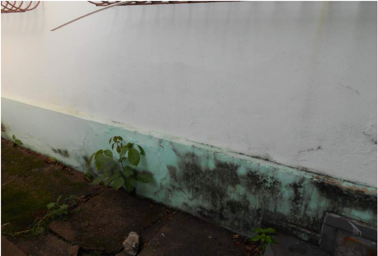
Foto 12 – Manchas de mofo na alvenaria.
