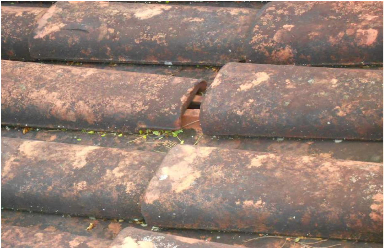
Foto 04 – Deslocamento de telhas.
