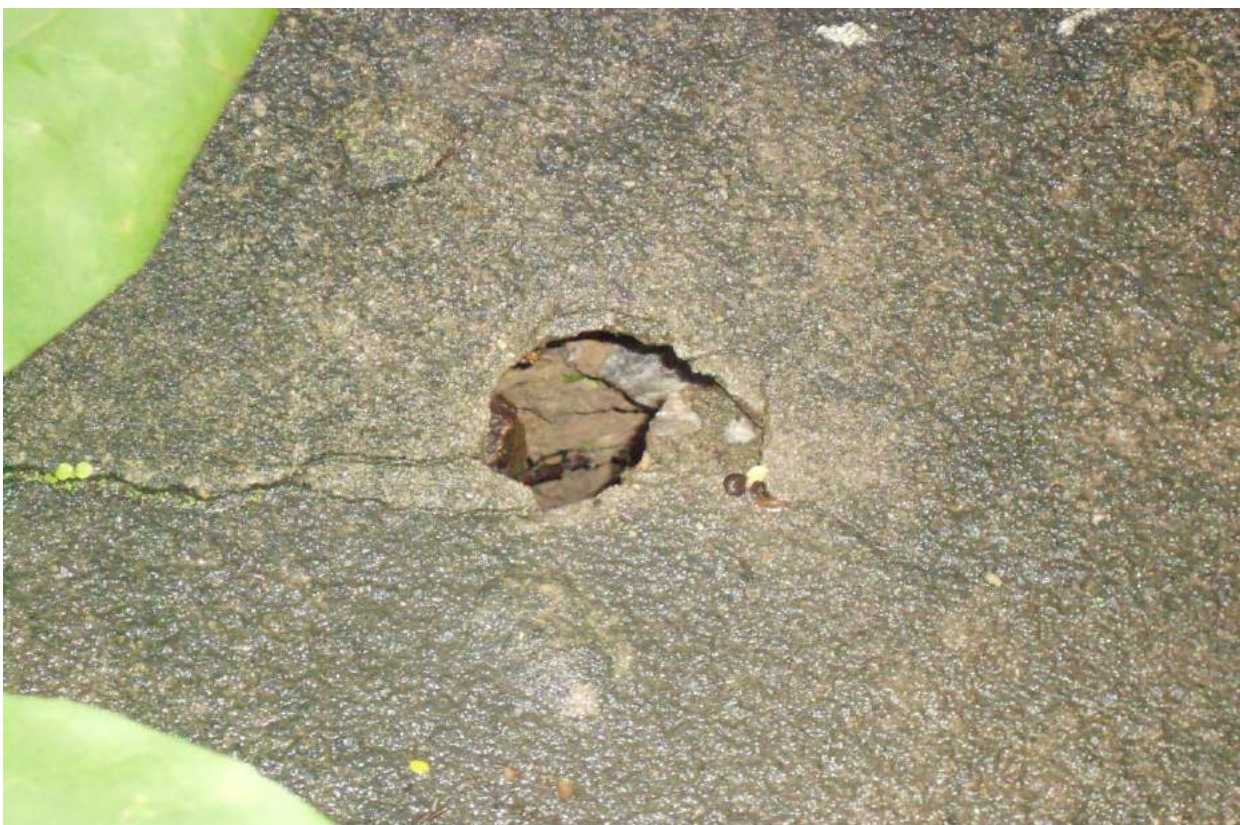
Foto 10 – Orifício no piso da área de claridade.
