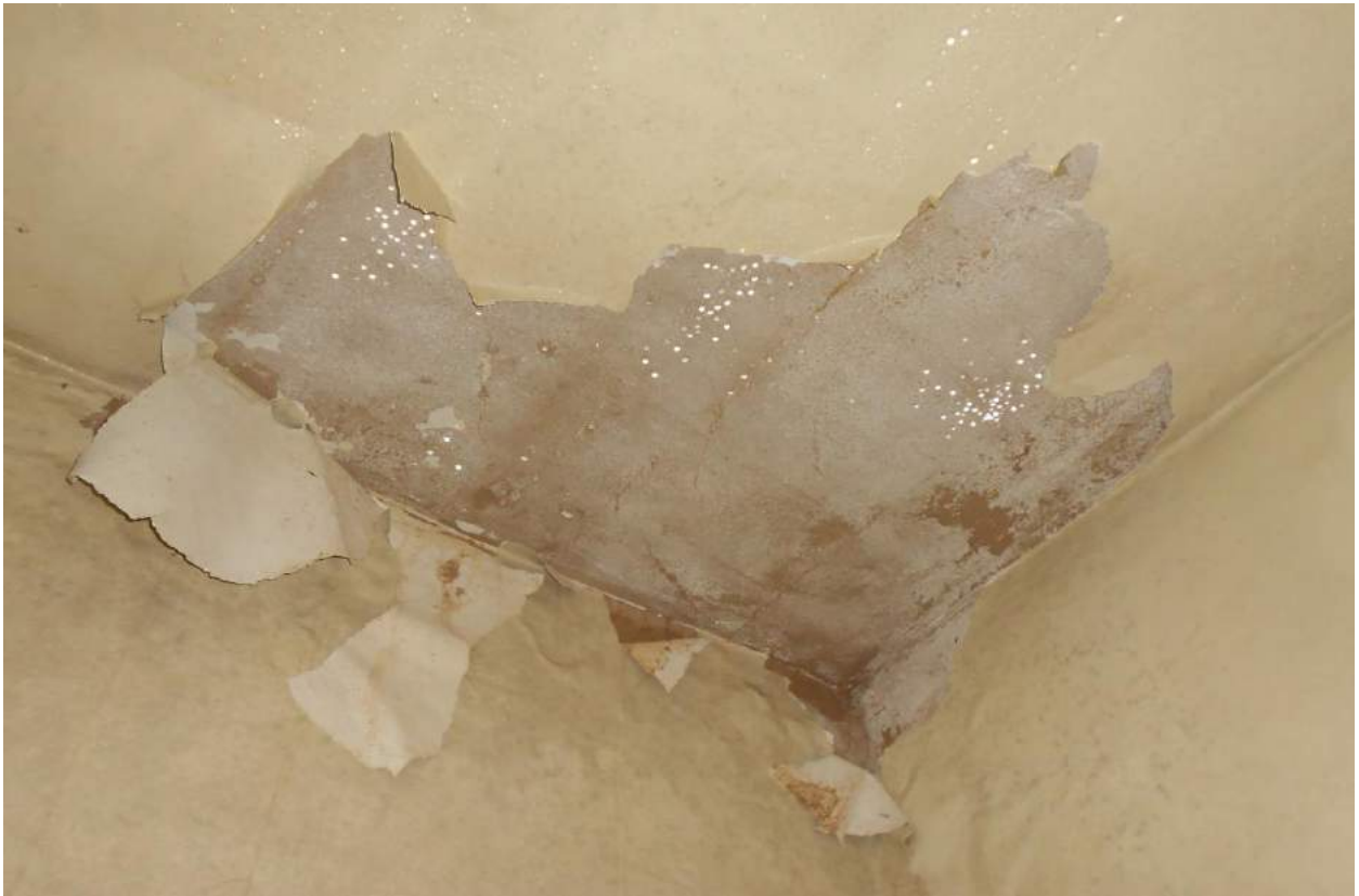
Foto 02 – Descascamento da pintura, provocada pela infiltração.
